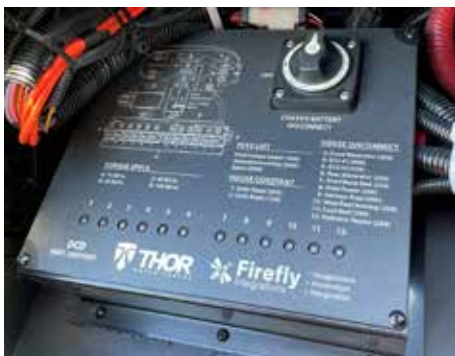
Commutateur principal de batterie situé sur le tableau des disjoncteurs 12 volts.
