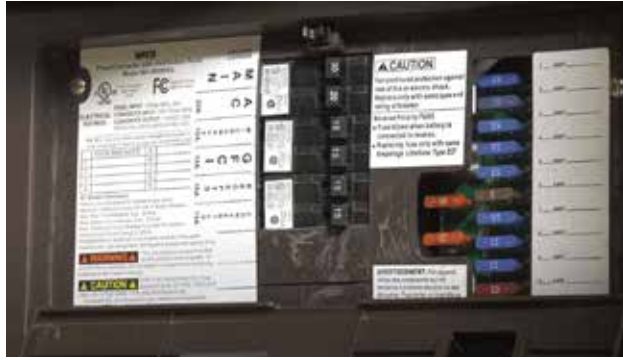
Disjoncteur et panneau de fusibles typiques de 30 A. Notez les étiquettes des circuits et des appareils.
