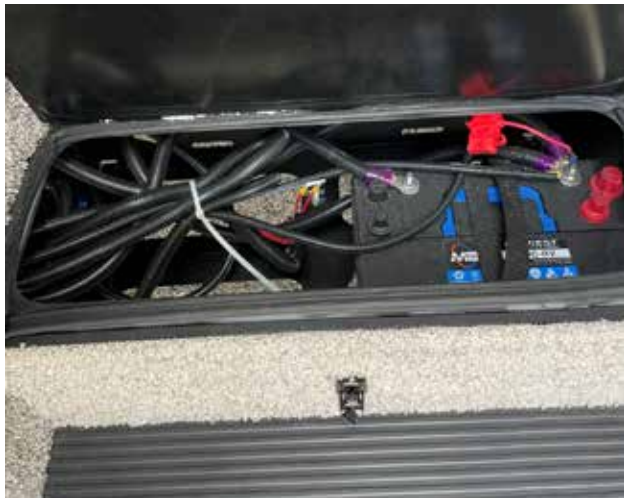
Emplacement typique de la batterie d'un autocaravanes de classe C (sous la marche d'entrée)
