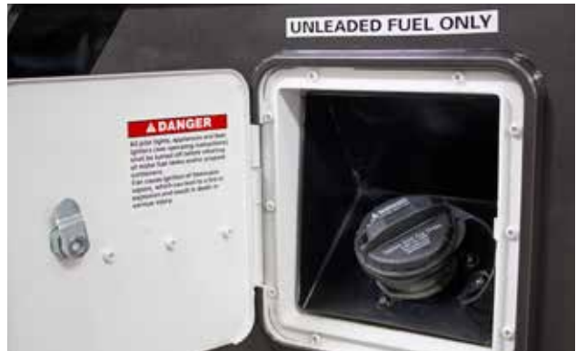
Entrée du réservoir de carburant pour le système de transfert de carburant
