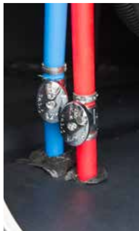
Vannes de vidange à point bas typiques
